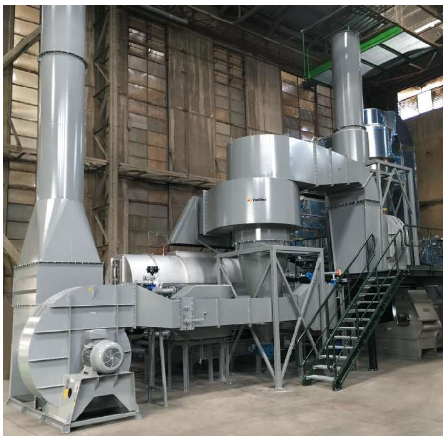
Installation hygiénisation des semences « ThermoSeed"»
